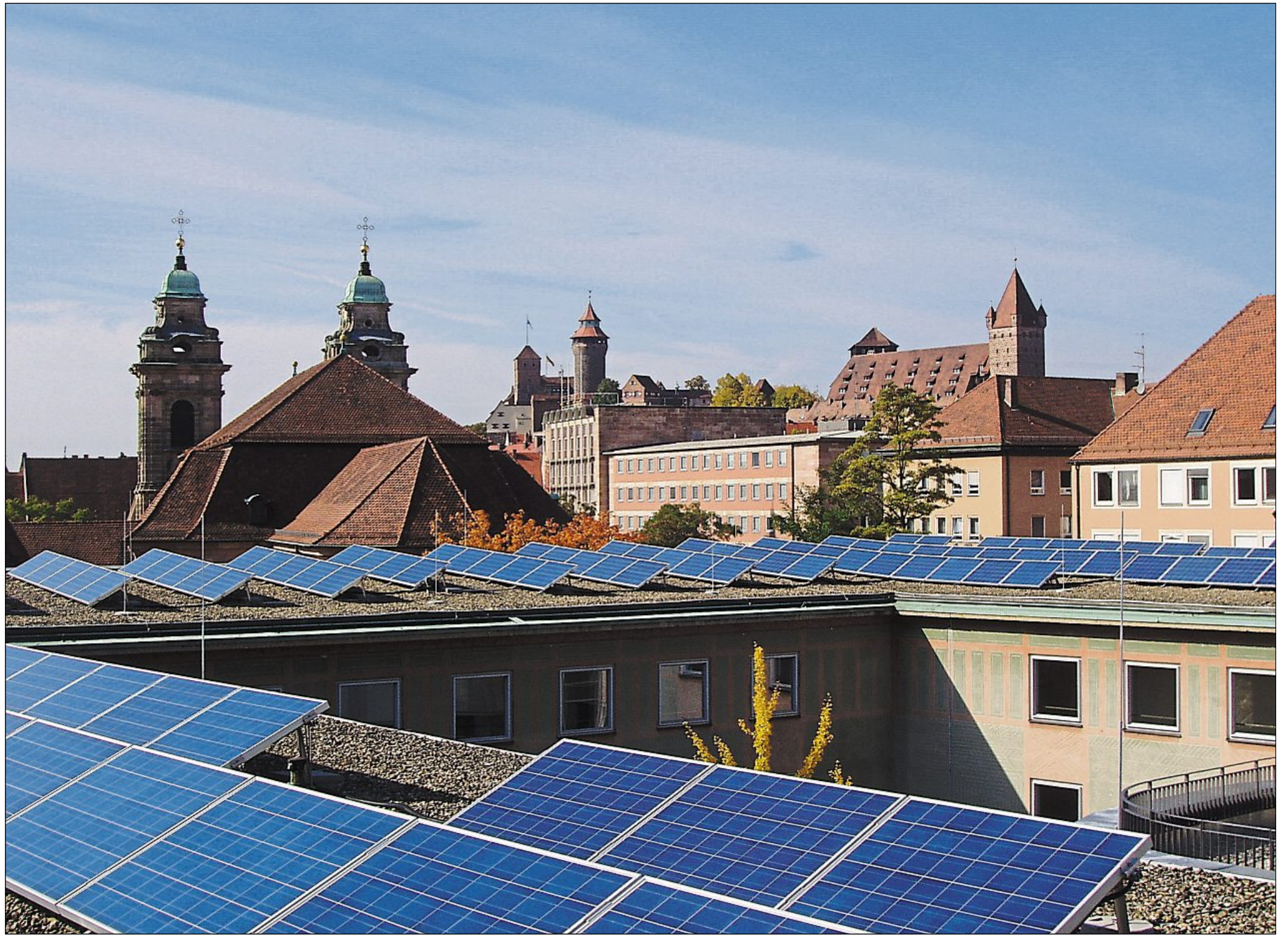
In Nürnberg sind schon seit Jahren Photovoltaikanlagen auf kommunalen Dächern. Diese Anlage wurde im April 2006 auf dem Willstätter Gymnasium installiert.
